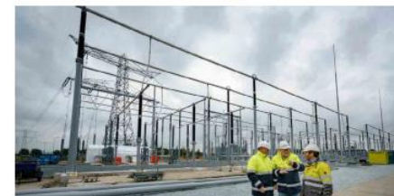
HS-MS station (van 110-150 naar 3-23 kV)
